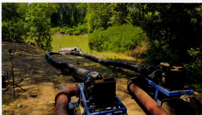
8. kép. Gyova-Mámai Holt-Tisza feltöltése úszóműre telepített szivattyúval, nyomásfokozó szivattyú (Pajtás) közbeiktatásával (a KÖTIVIZIG archívumából)
