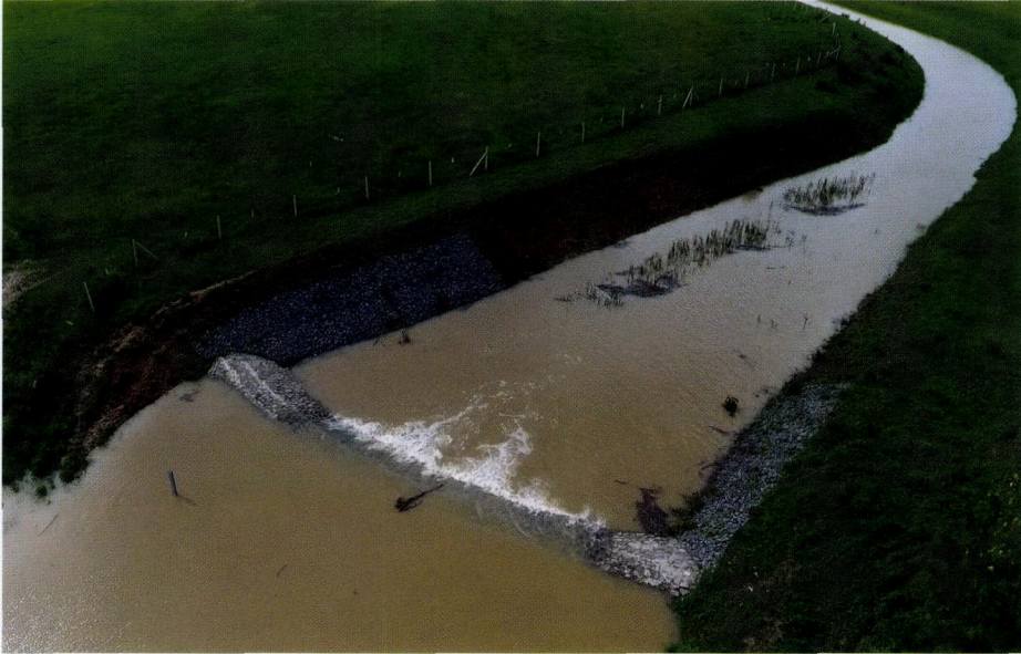
3. kép. Vízpótlási célú fenékküszöb a Csaronda-főcsatornán
