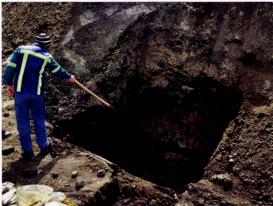
5. kép. Hódjárat feltárása az árvízi rongálódások helyreállítása során
